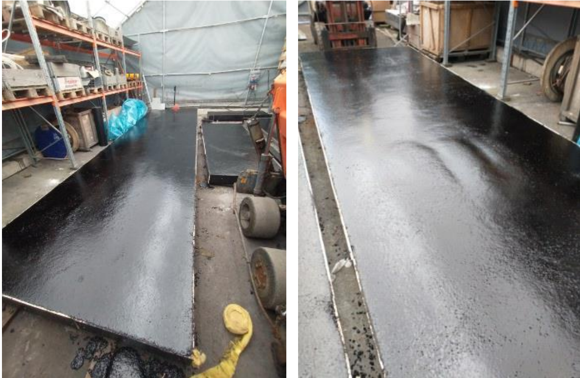
Figur 5 Andra lagret gjutasfalt har påförts den stora provplattan med fyra olika primer-/förseglingsprodukter. Kraftiga bulor bildades på de delar av provplattan som förseglats
