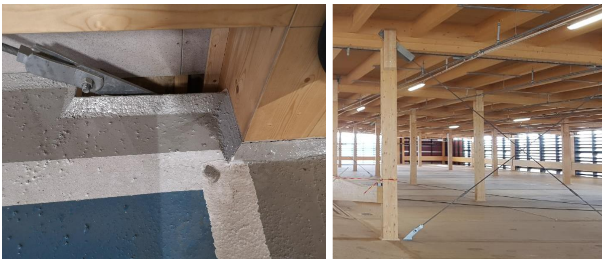
Figur 11 Exempel på stag i parkeringshus av trä
